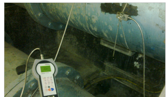
Auf großer Abwasserleitung installierter KATflow 200
