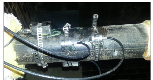
Am Rohr befestigte PT100-Temperatursensoren
